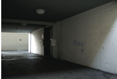
Abb.7__Eingangssituation, die uneinsichtig ist, dunkel und mit potenziellen Angst-Nischen
